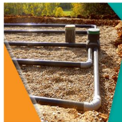
Déconnexion de fosse septique
